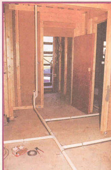
Общий вид системы трубопроводов. Главная труба, отводы к настенным переходным коробкам, труба на верхний этаж.
